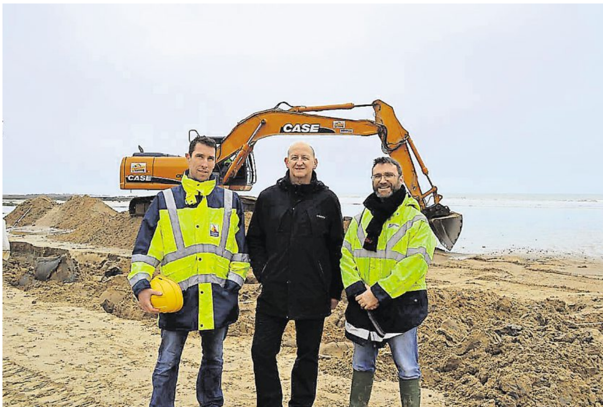
Fabien Loubere, directeur adjoint des services techniques, Arnaud Balley, directeur du bureau d'étude Écoplage, et Gérard Mongellaz, conseiller municipal délégué à la voirie, veillent au bon fonctionnement d'Écoplage, actuellement en travaux.
