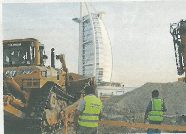
Au pied du célèbre hôtel Burj El Arab de Dubaï, Ecoplage a installé son système de drainage sur 950 mètres afin de lutter contre l'érosion de la plage.
